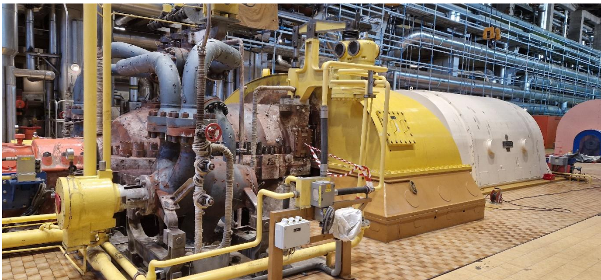
Slika 39. Parna turbina, Jugoturbina 50 MW TE-TO Ljubljana, prije remonta [21]
