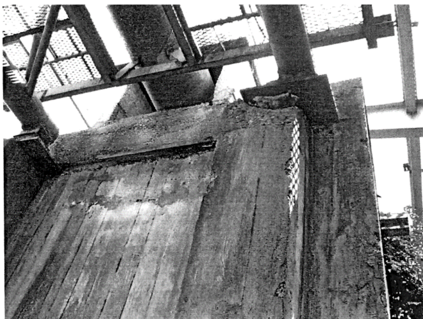
Slika 10. Oštećenja betonskih oslonaca noseće konstrukcije – Podsused
