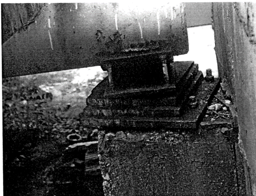
Slika 11. Pomak ploča na kliznom osloncu noseće konstrukcije – Rakitje
