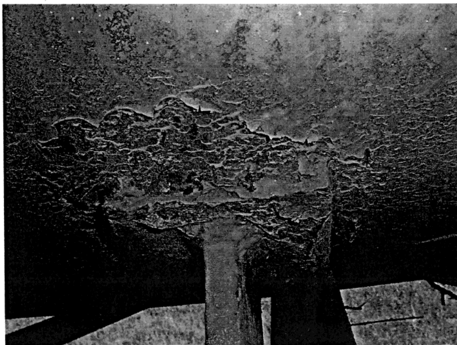
Slika 14. Oštećenje zaštitnog premaza i korozija oko zavarenog spoja
