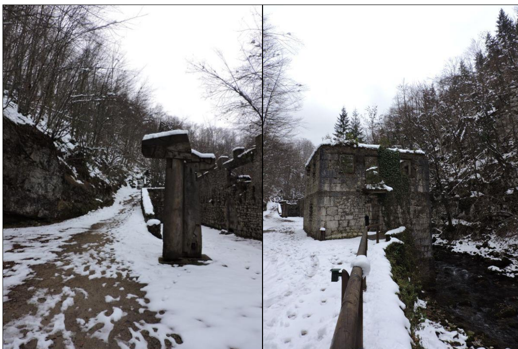
Slika 9: Ruševne zidine stare vodenice (pilane)
