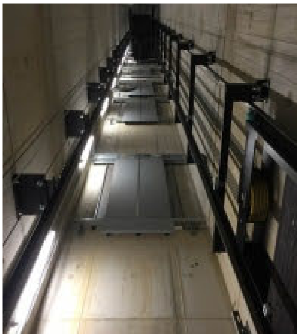
Slika 21 - Betonsko vozno okno [6]
