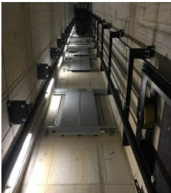
Slika 21 - Betonsko vozno okno [6]
