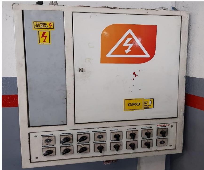
Slika 10. Glavni razvodni ormar [16]
