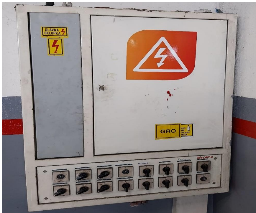
Slika 10. Glavni razvodni ormar [16]
