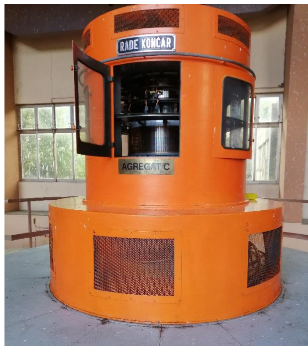
Slika 5: Hidrogenerator C, Hidroelektrane Orlovac prije remonta.
