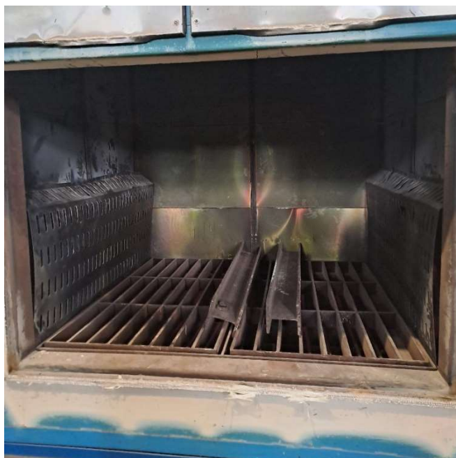
Slika 3. Unutrašnjost električne peći (izvorno autor)
