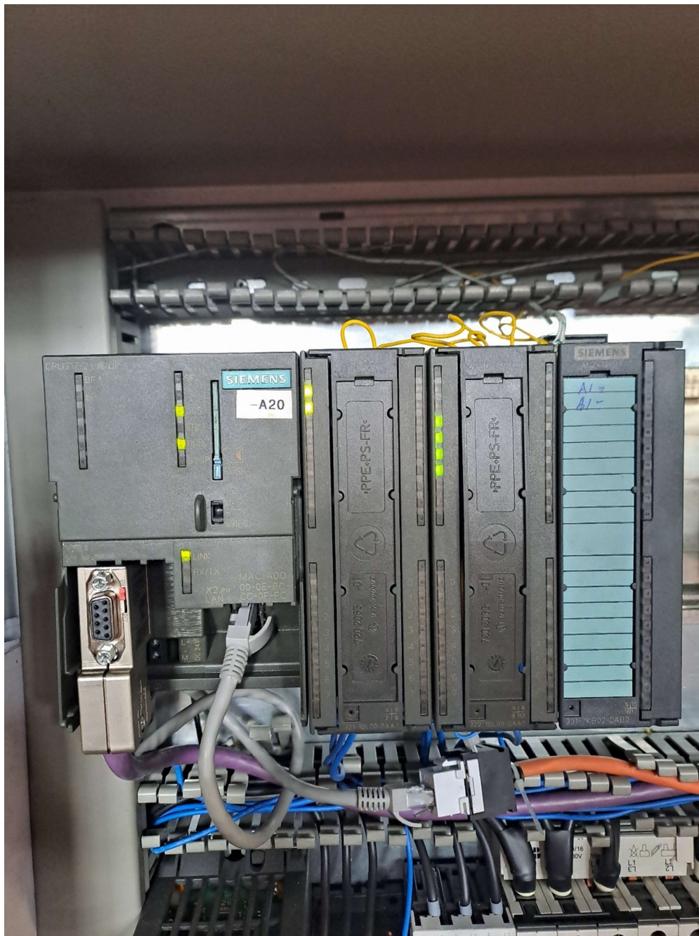
Slika 12. Korišteni PLC Siemens S7-300 (izvorno autor)
