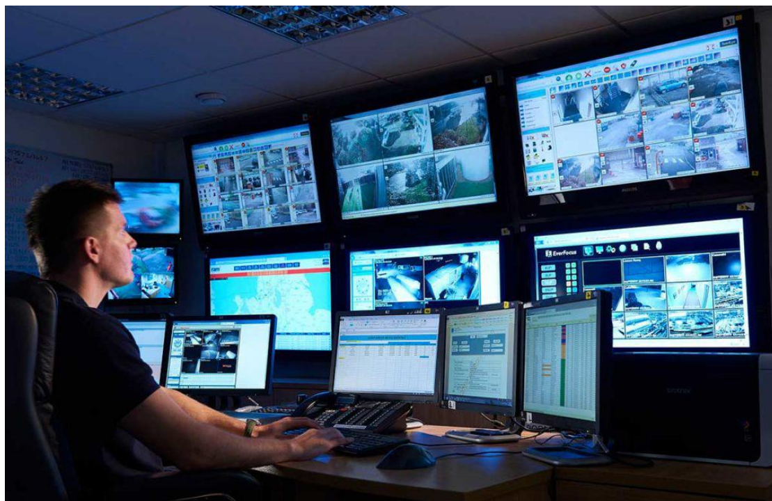
Slika 3.2. Prikaz kontrolne sobe, centralni dojavni sustav [4]
