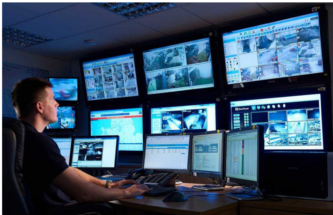
Slika 3.2. Prikaz kontrolne sobe, centralni dojavni sustav [4]
