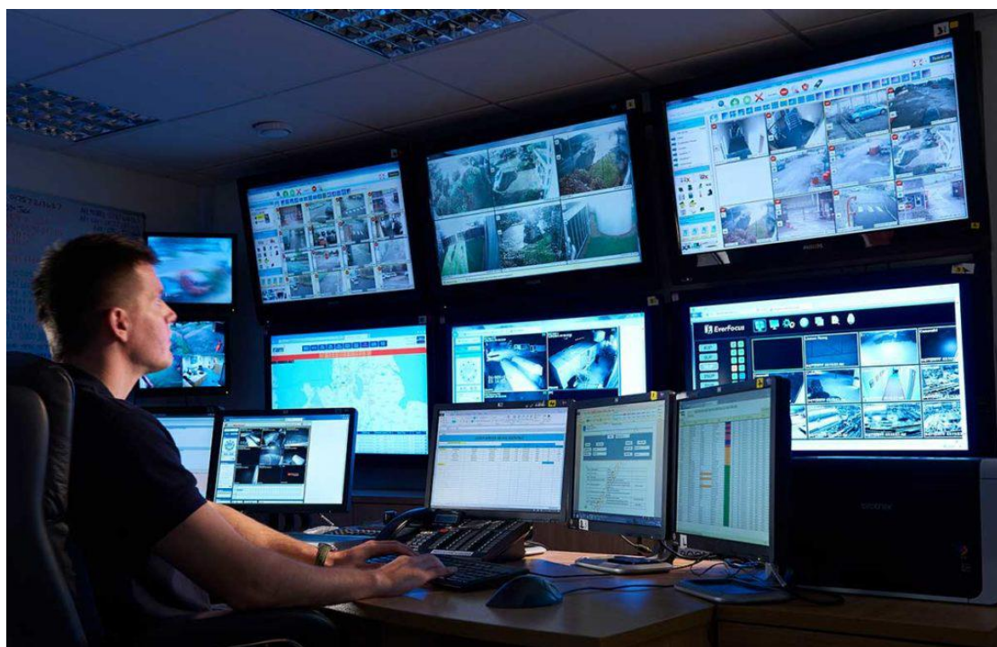
Slika 3.2. Prikaz kontrolne sobe, centralni dojavni sustav [4]
