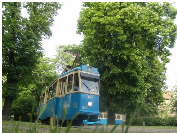
Slika 35: Primjer Ugroženosti tramvajske kontaktne mreže od visokih stabala
