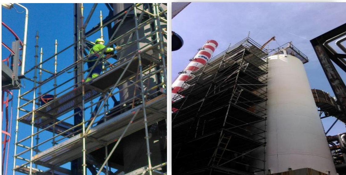
Slika 2. Pravilno složena laka skela u rafineriji
