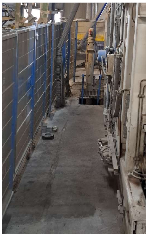
Slika 21. Zaštita u obliku rešetke ili ograde
