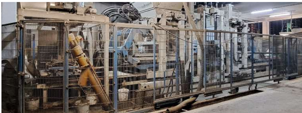
Slika 8. Zaštitna ograda na stroju za proizvodnju betonskih elemenata
