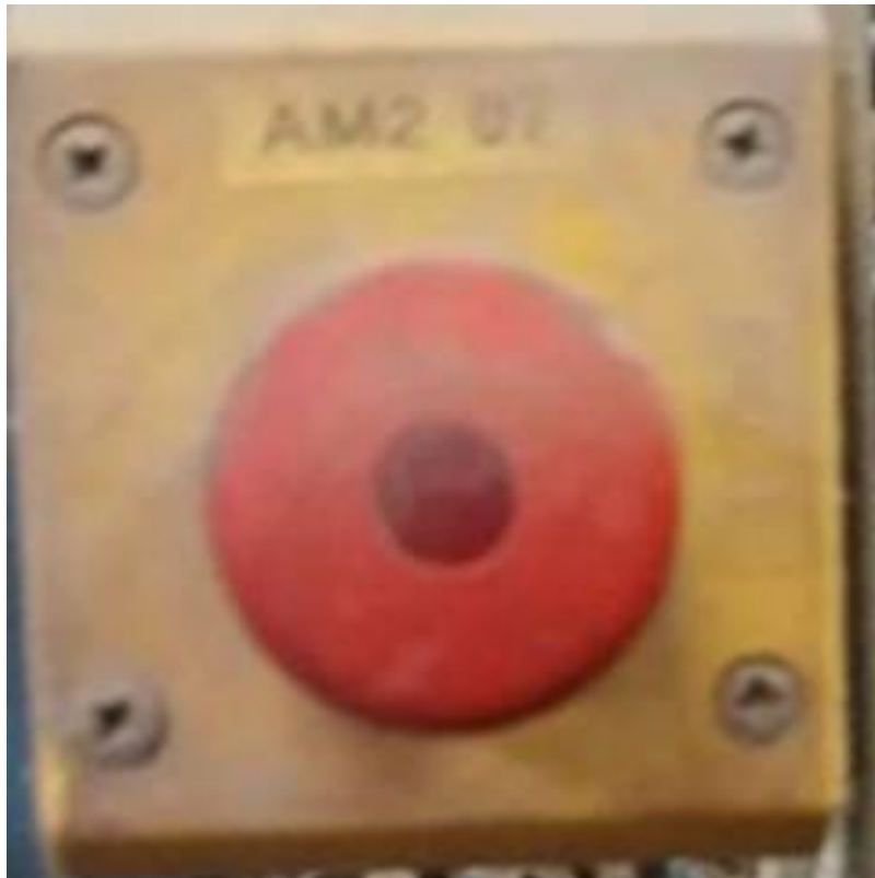
Slika 11. Tipkalo za isključenje struje u cijelom objektu
