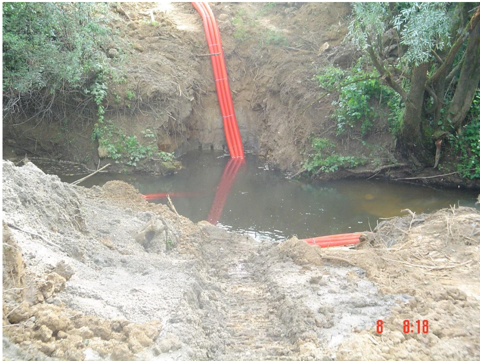
Slika 4: Elektroenergetski kabelski vod (prelaz preko potoka)
