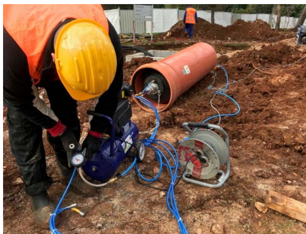
Slika 43: Kompresor za tlačno ispitivanje cijevi [34]
