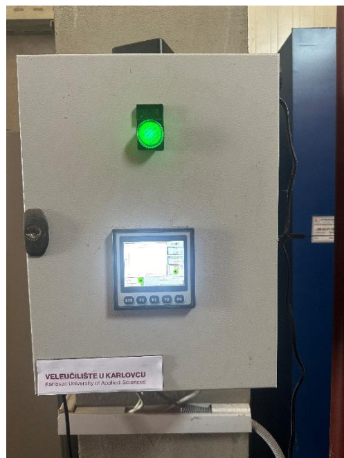
Slika. 9 Razvodni ormarić Izvor: Autor
