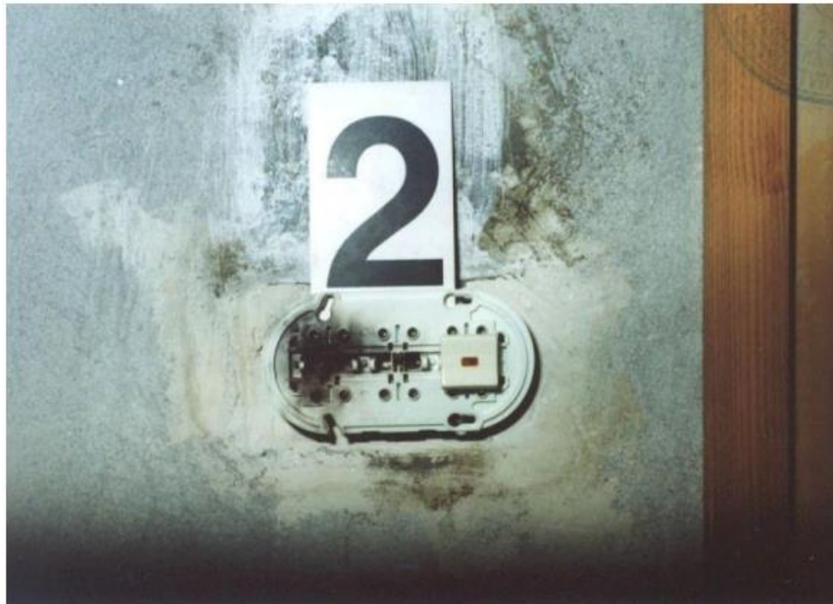
Slika 16. Karbonizacijsko začađenje na višestrukom prekidaču [24]
