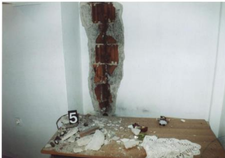
Slika 15. Podžbukno preopterećenje strujnog kabela [24]
