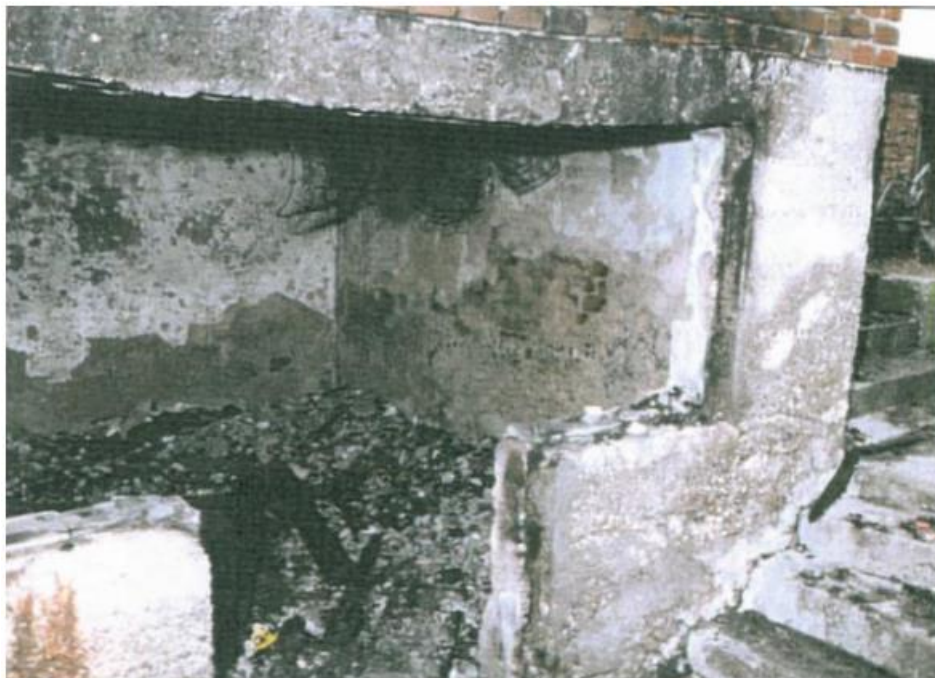
Slika 19. Tragovi gorenja na betonu [24]
