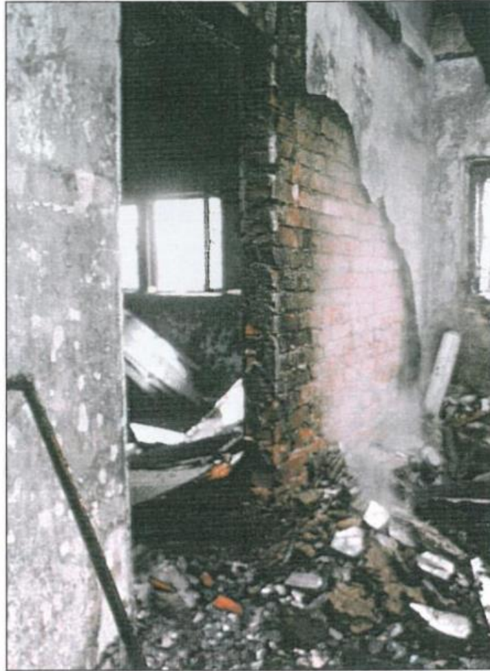
Slika 20. Otpala žbuka na intenzivnom djelovanju požara [25]
