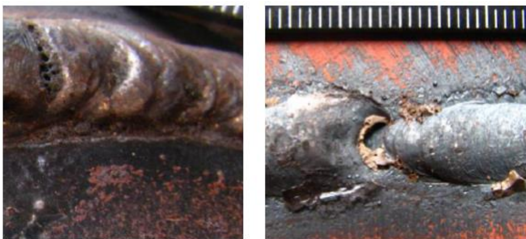
Slika 59. Prikaz grešaka zavarenih spojeva. [12]
