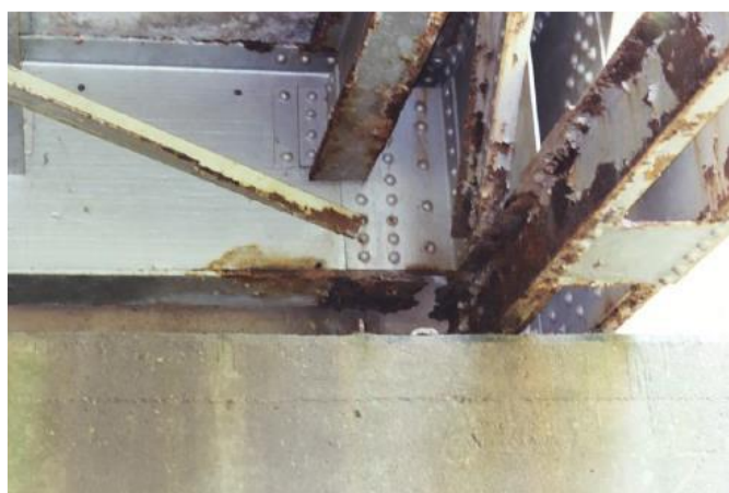
Slika 10. Korozija čeličnog mosta. [12]
