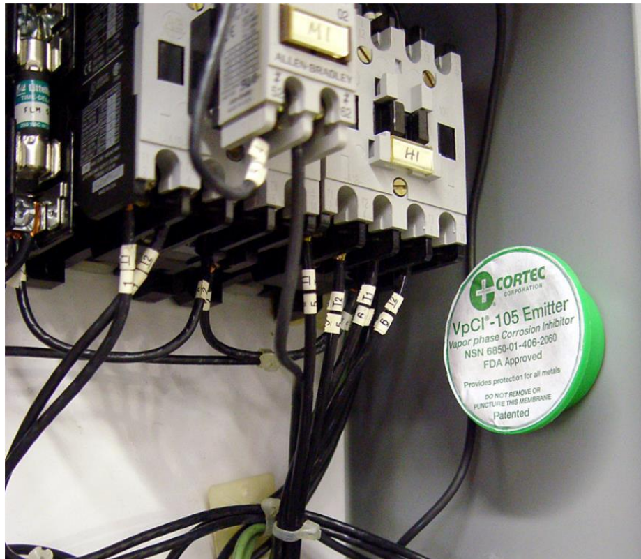
Slika 33. Inhibitor koroziije u razvodnom ormaru. [17]
