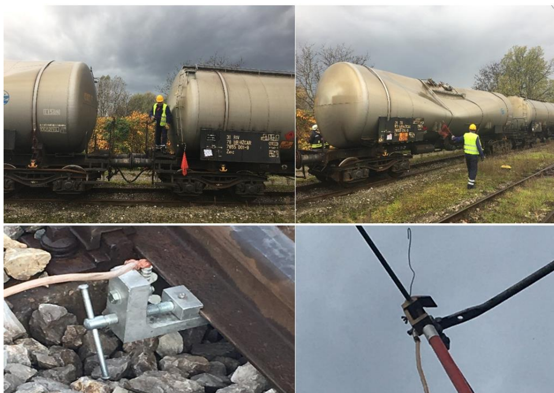
Slika 15 .Uzemljenje željezničkih vagona
