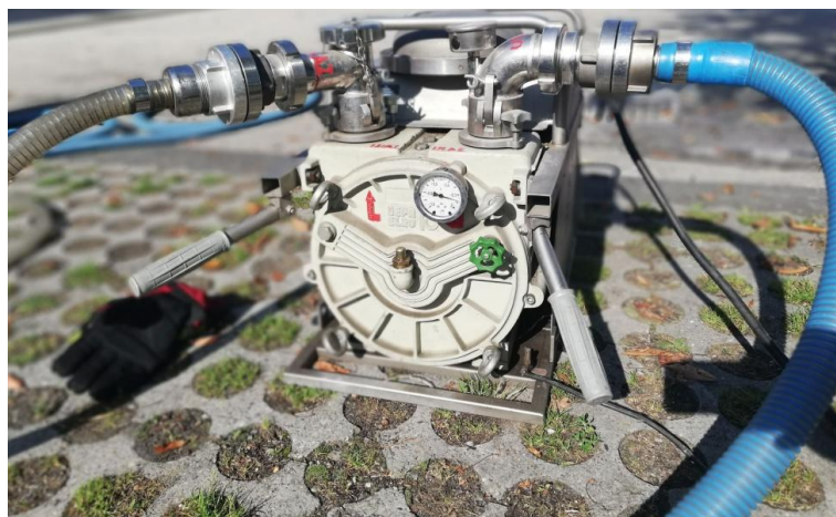
Slika 10. Prikaz pumpe za pretakanje lakozapaljivih tekućina [10]
