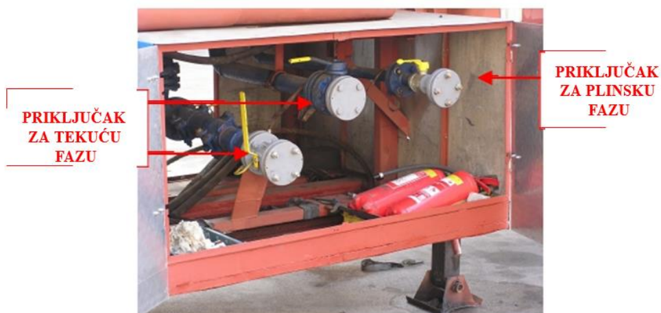
Slika 13. Priklučki na plinskoj autocisterni [8]
