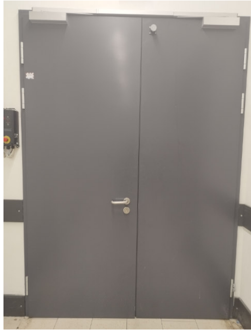
Slika 7. Prikaz protupožarnih vrata u trgovini
