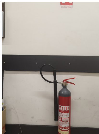
Slika 5. Prikaz protupožarnog aparata u trgovini
