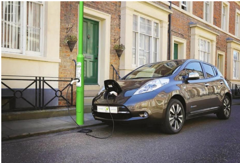
Slika 8. Punjač za automobile na rasvjetnom stupu [9]
