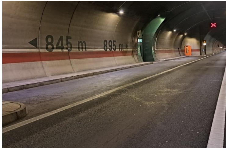
Slika 6. Ugibalište u tunelu Sv. tri Kralja u smjeru 2 (Zagreb) [11]
