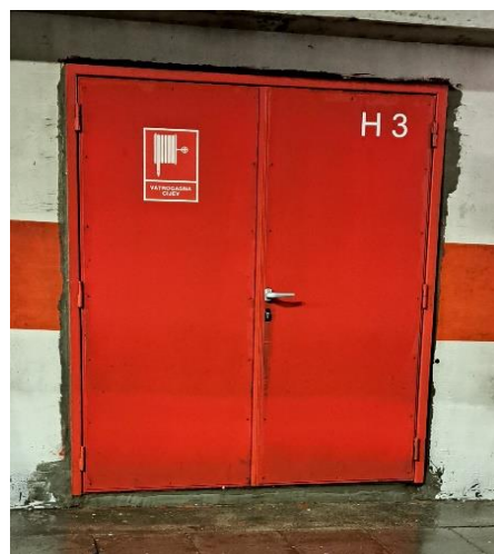
Slika 7. Hidrantska niša u tunelu Sv. tri Kralja [11]
