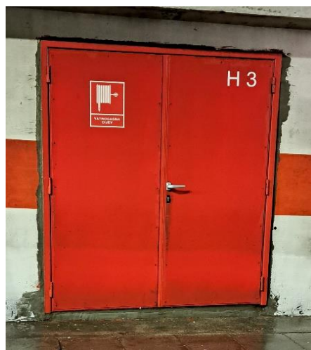
Slika 7. Hidrantska niša u tunelu Sv. tri Kralja [11]
