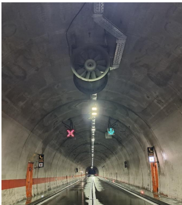
Slika 11. Ventilator u tunelu Brezovica [11]
