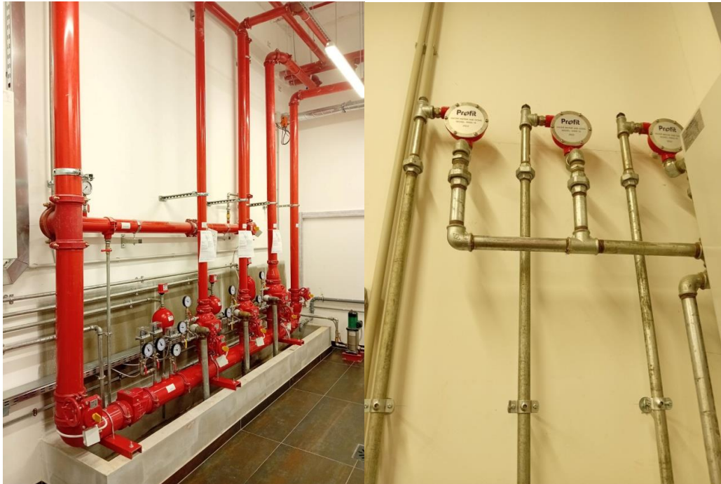
Slika 49. Sprinkler stanica sa pripadajućom armaturom (lijevo), alarmno zvono (desno) [21]
