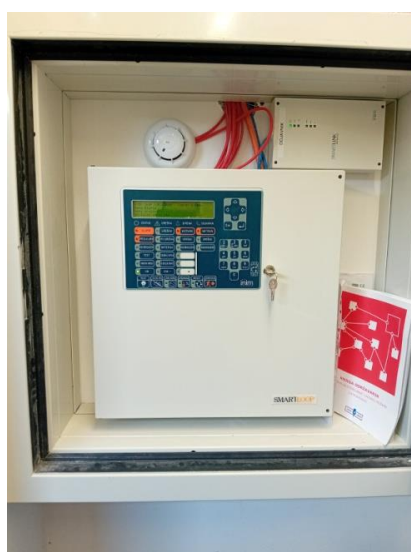
Slika 45. Vatrodojavna centrala u trgovačkom centru Stop & Shop [21]
