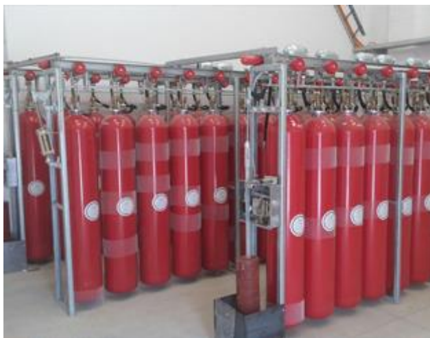
Slika 35. Baterije čeličnih boca u kojima se nalazi ugljični dioksid [17]
