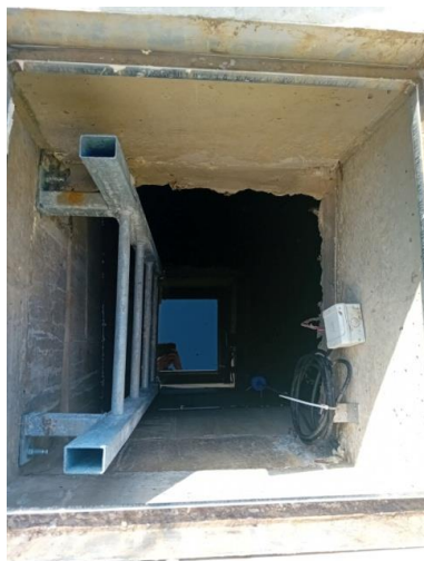
Slika 47. Otvor za ulaz u podzemno akumulacijski spremnik gdje se nalazi potopna sprinkler pumpa [21]
