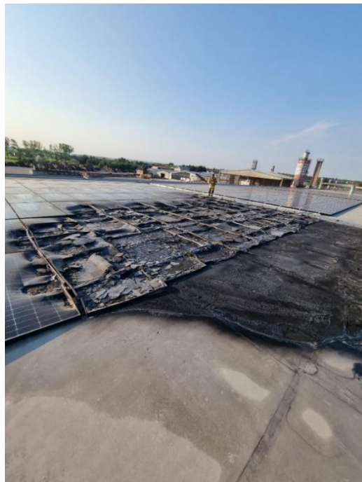
Slika 32. Požar je izazvao veliku količinu štete [11]
