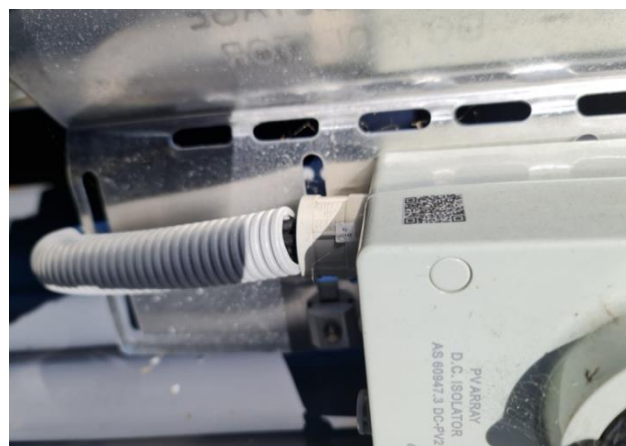
Slika 10. Nepravilno instaliran spojni dio cjevovoda i spojne kutije električnih kablova [7]
