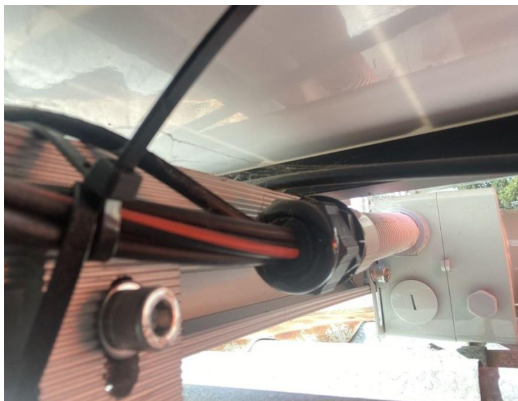
Slika 12. Nepravilno korištenje uvednice koja se koristi za ulaz više vodiča [7]
