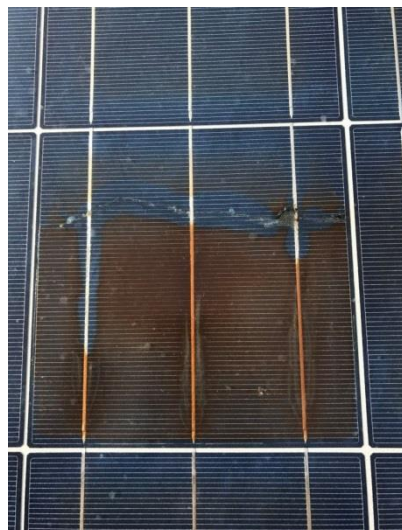
Slika 21. Degradaciju ćelije i stvaranje vruće točke od pukotine u fotonaponskom panelu [6]
