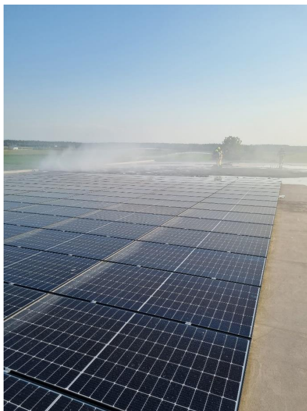
Slika 27. Požar ploče na krovu [11]
