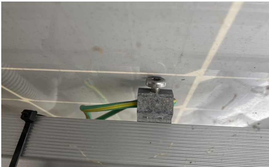
Slika 19. Nepravilno postavljenu spojnicu za uzemljenje fotonaponskog panela [8]
