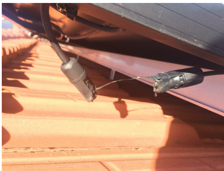
Slika 18. Oštećenje koje je nastalo spajanje različitih konektora [7]
