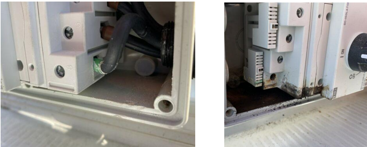
Slika 9. Djelomično uranjanje izolatora i vidljivu koroziju – željezni vijak [7]
