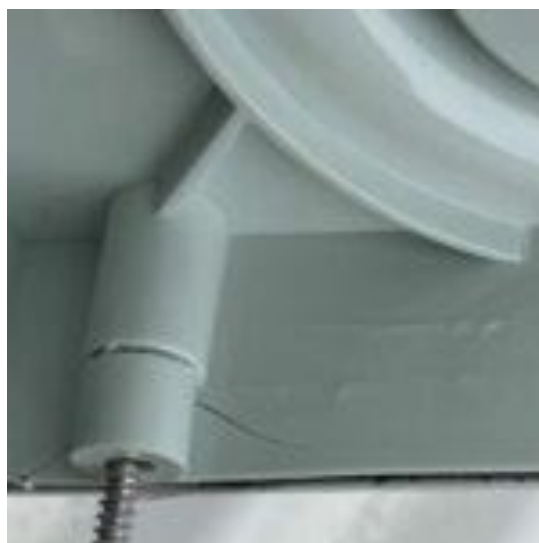
Slika 15. Previše zategnut vijak koji uzrokuje oštećenje kućišta razvodne kutije [7]
