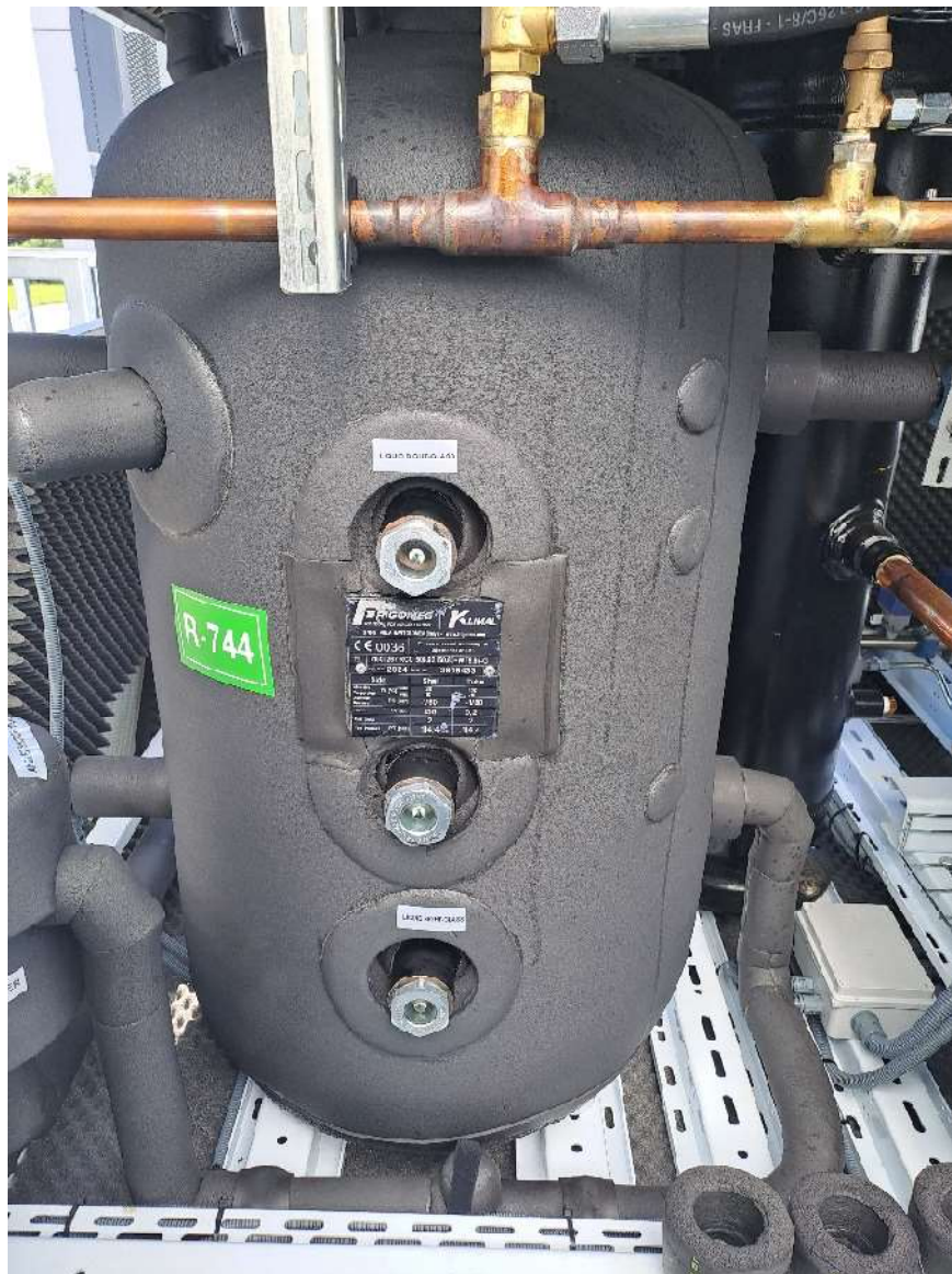
Slika 25. Pozicije kontrolnih stakala na ugrađenom spremniku
