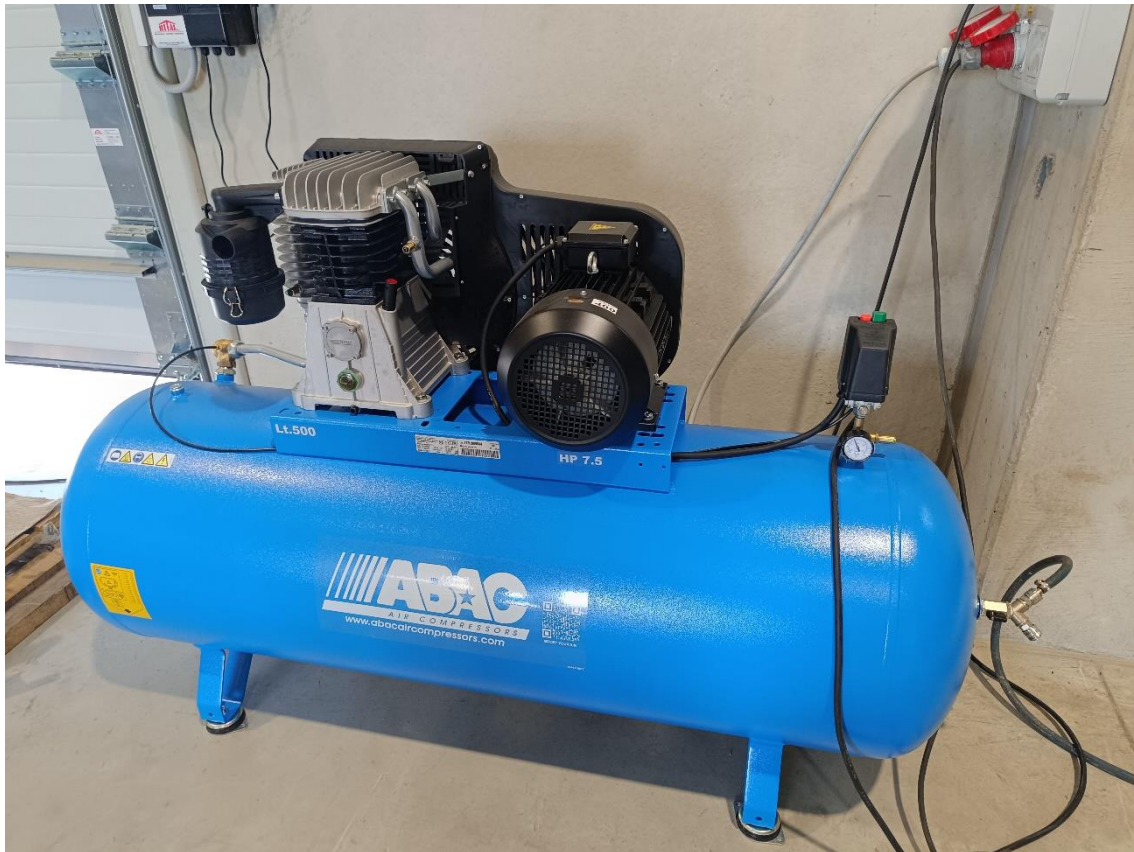
Slika 9. Klipni kompresor tvrtke "METALLIS d.o.o."
