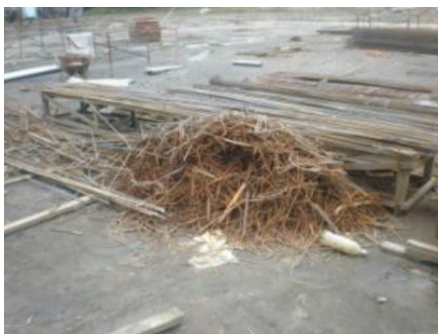
Slika 3. Otpad od čelične armature [10]
