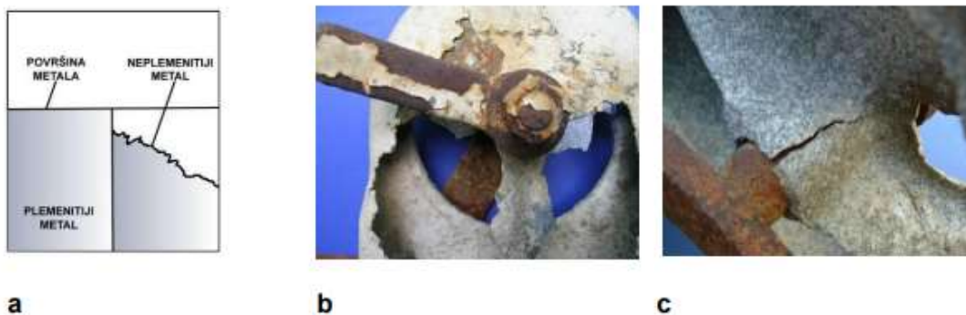
Slika 12. Galvanska korozija: a – shematski prikaz, b- stezni zatvarač, c- lom. [1]
