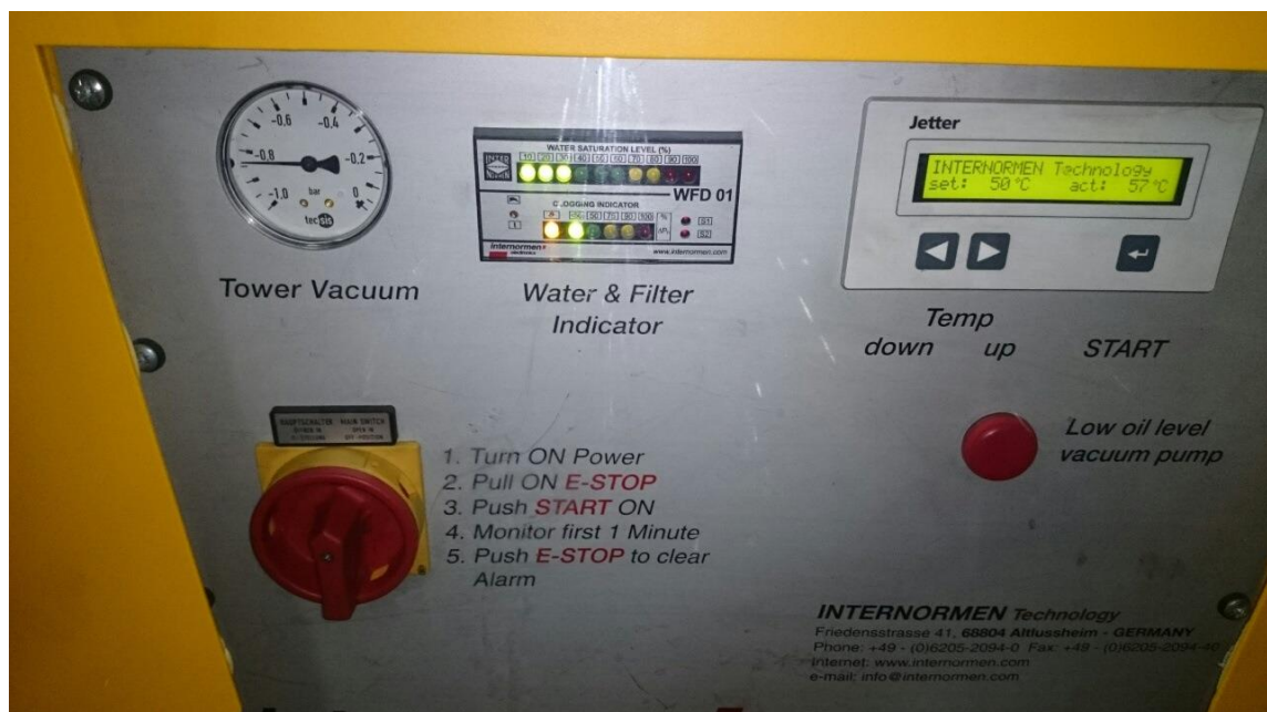
Slika 35. Kontrolna ploča IFPM 21 uređaja s prikazom trenutne postotne zasićenosti vodom, temperature i vakuuma (podtlak)
