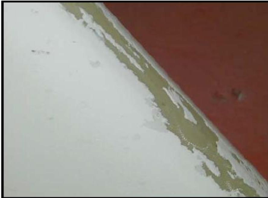
Slika 49. Erozijska šteta na vertikalnom stabilizatoru [3]
