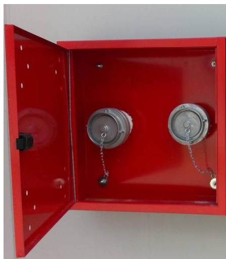
Slika 33. Predodžba priključka sprinkler sustava na vatrogasno vozilo
