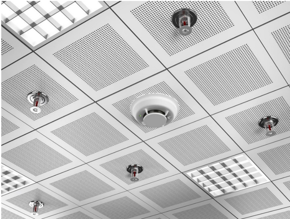
2. Slika: Primjer spuštenog stropa s ugrađenim sprinkler mlaznicama (korisnici građevine najčešće vide samo ovaj dio sustava) [13]
