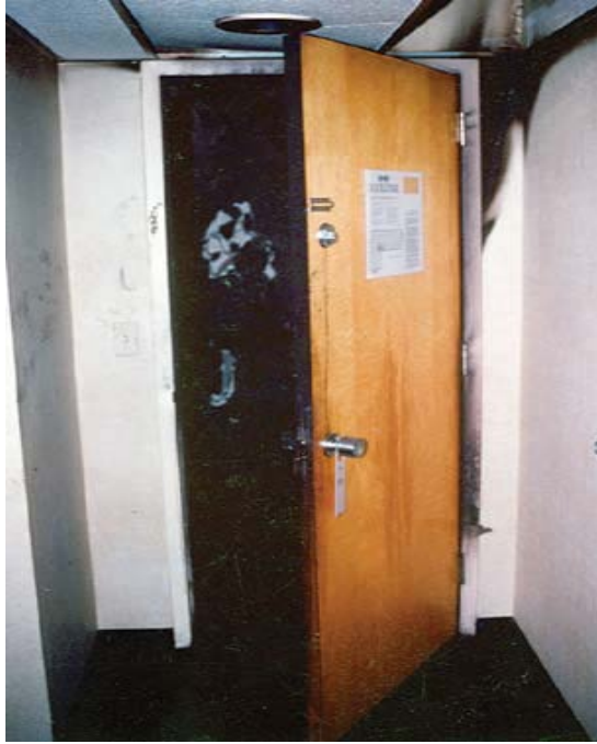
Slika 22 : Soba na desetom katu s minimalnom štetom [22].
