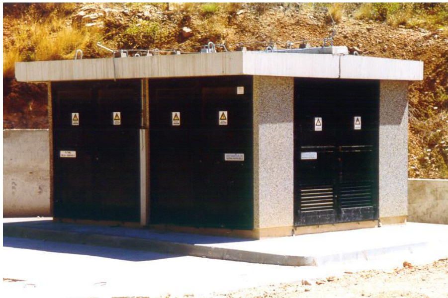
Sl. 15. Uljna transformatorska stanica [9]
