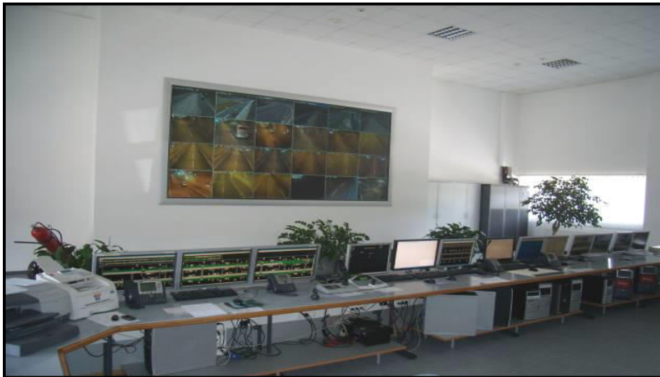
Sl. 10. Dojavni centar Tunel Mala Kapela [4]
