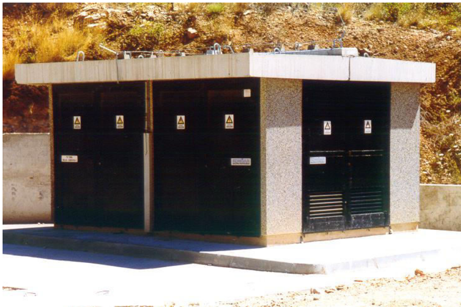
Sl. 15. Uljna transformatorska stanica [9]
