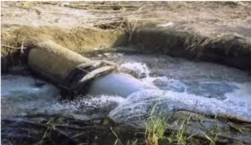
Slika 1. Prikaz neadekvatnih objekata za odvodnju otpadnih voda
