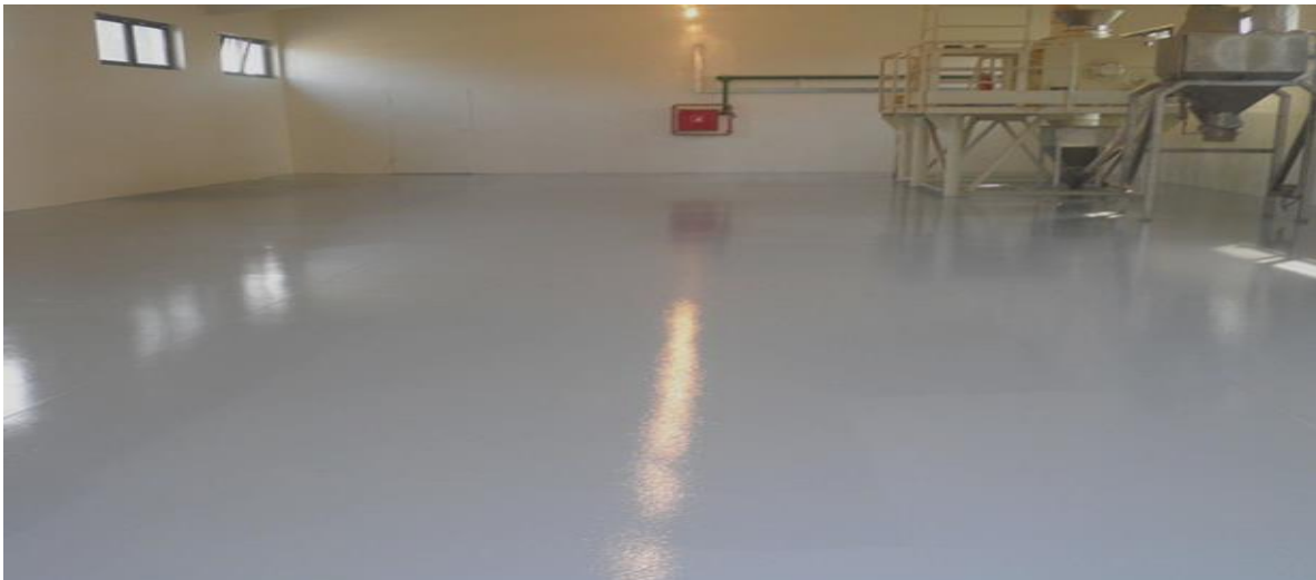
Slika 1. Podna obloga sa epoksidnim premazom.
