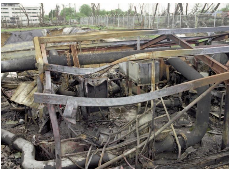
Slika 27: Ostaci vodocrpne stanice nakon ugašenog požara [7].
