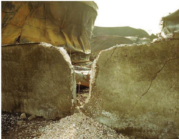
Slika 23: Spojno mjesto zida sabirnog prostora nakon ugašenog požara [7].
