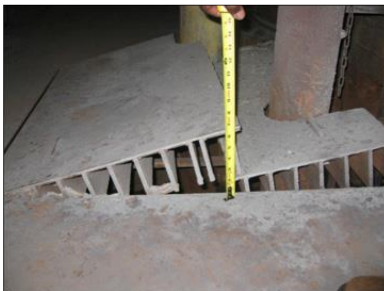
Slika 12. Pomicanje pokrovnih ploča izazvano eksplozijom vodika [14].
