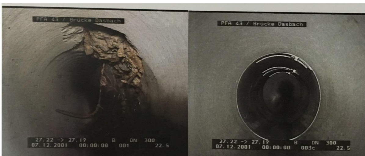
SI. 3. Postupak popravka: Sustavi naglavka [4]
