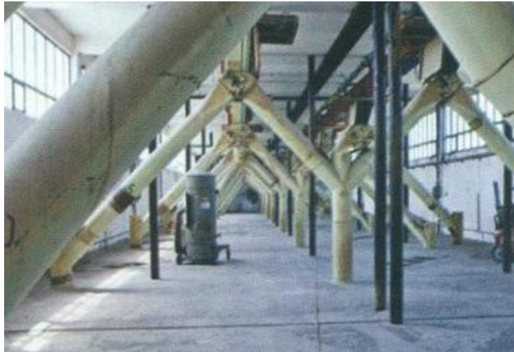
SI.9. Galerija silosa [10]
