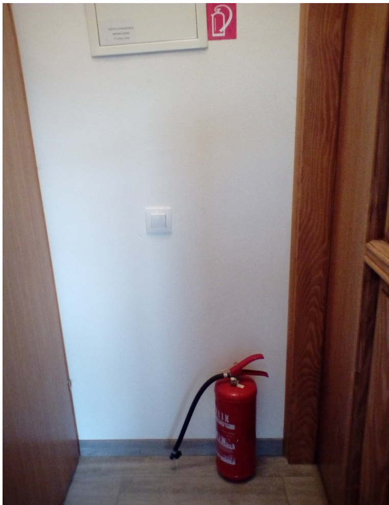
Slika 21. Vatrogasni aparat postavljen u pratećem objektu kamp odmorišta [14]
