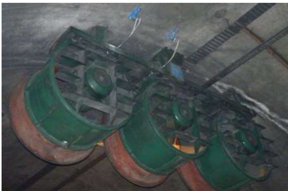
Slika 17. Grupa od 3 ventilatora, tunel Učka [13]
