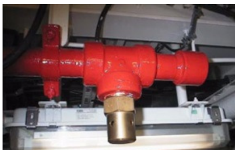
Sl. 20. Primjer mlaznice sustava za gašenje požara halonom
