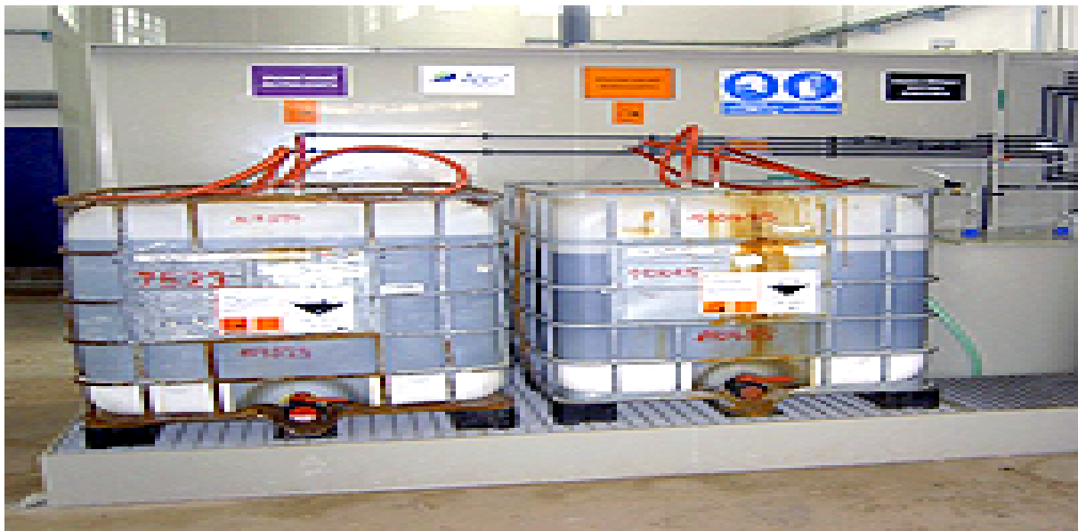
Slika 7. Tehnologija za pročišćavanje otpadnih voda u prerađivačkoj industriji[16].
