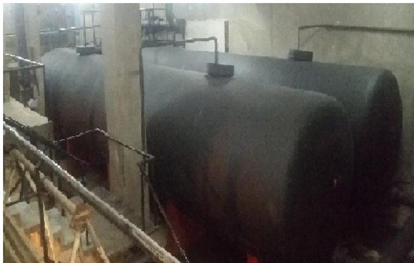
Slika 12. Prikaz rashladnog sustava
