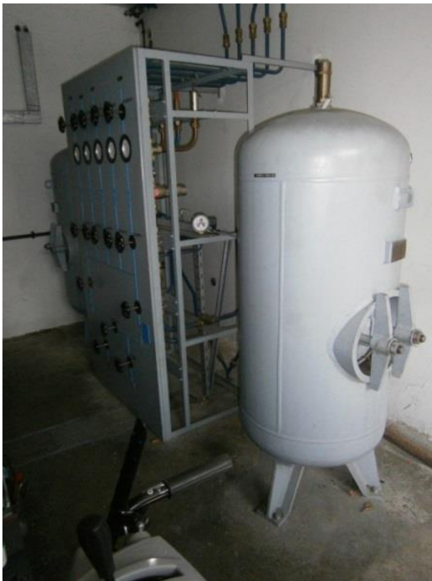
Slika 16. Spremnik zraka s razdjelnikom
