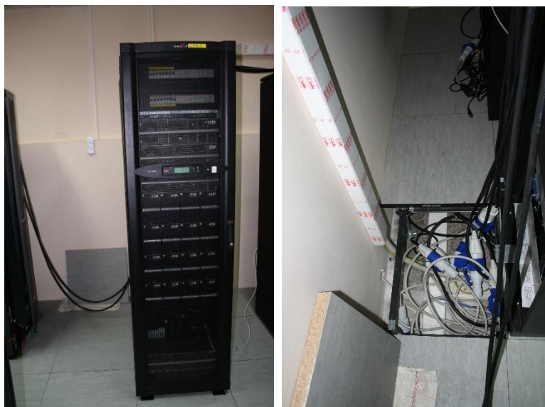
Sl. 19. Ormar sa baterijama (UPS) za rezervno napajanje i kablovi iza UPS ormara [14]
