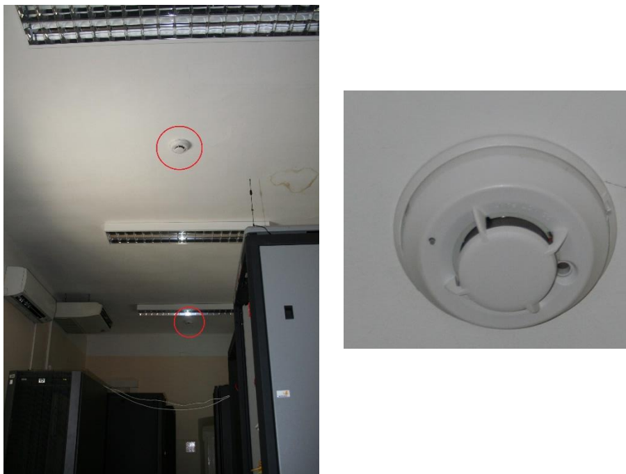
Sl. 21. Detektor požara WS4916 u serverskoj sobi [14]
