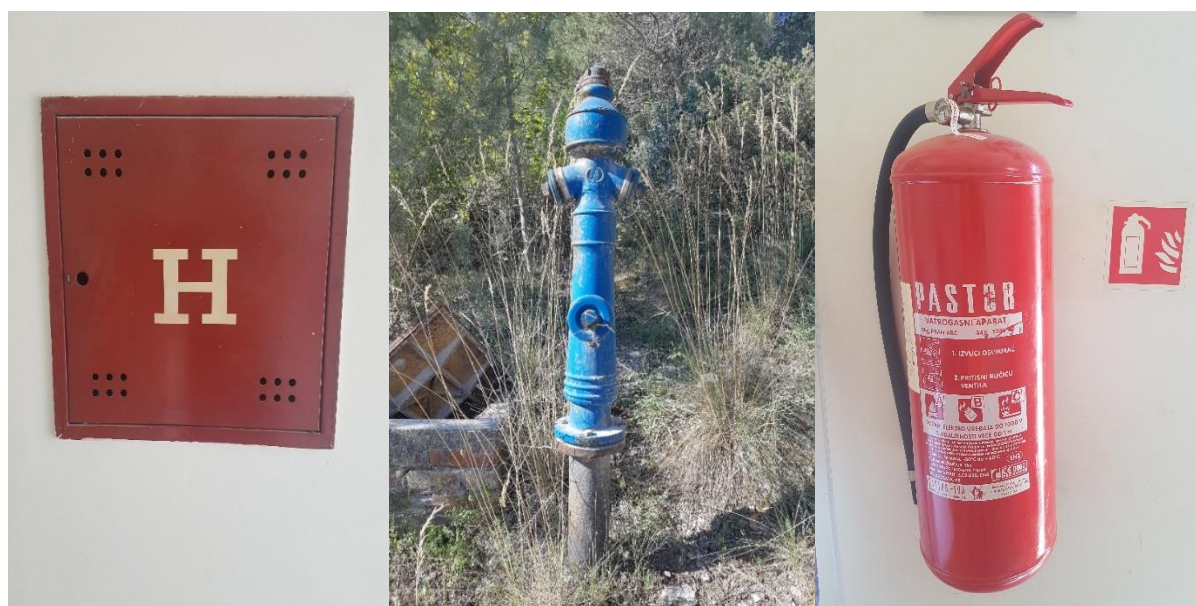
Sl. 3. Zidni i nadzemni hidrant, vatrogasni aparat
