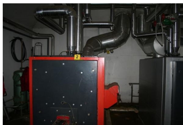
Sl.10. Peć i pripadajuća dimovodna cijev [15]
