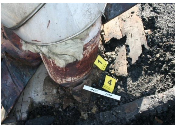
Sl.9. Mjesto ishodišta požara [15]
