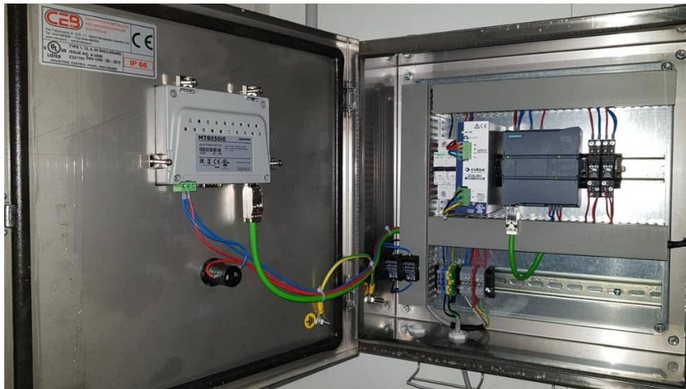
Slika 14. Elektro ormar / Autor slike 14: Antun Omrčen
